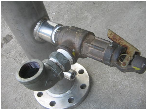
ทดสอบ Safety valve ของ Air receiver tank
